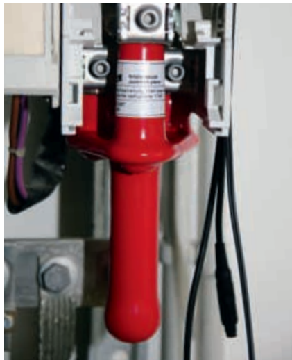
Bild 4: kurzgeschlossener Kabelanschluss in der Sicherungsschaltleiste
